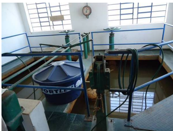
Figura 23. Vista dos Filtros
