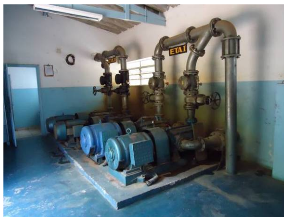
Figura 12. Vista dos Conjuntos Motor-Bomba
