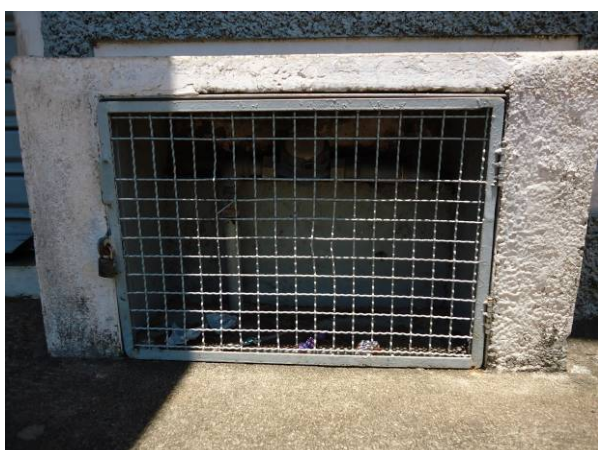
Figura 113. Vista do Hidrômetro na Rua Niterói, nº 51
