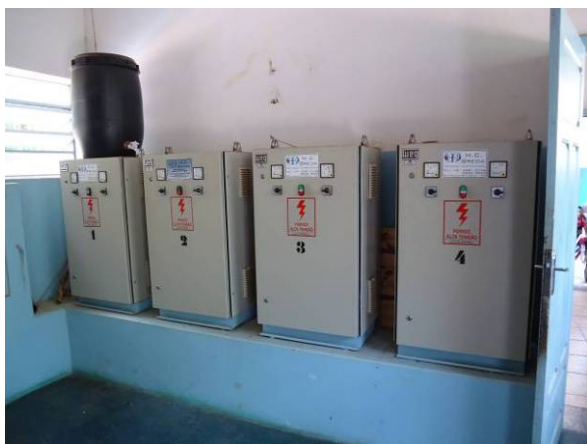
Figura 15. Vista dos Painéis Elétricos
