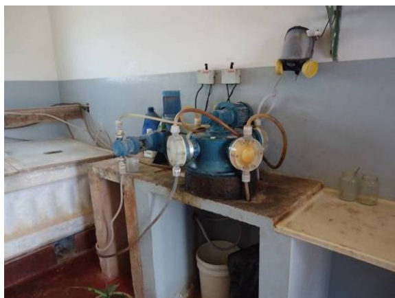
Figura 32. Vista das bombas dosadoras de produtos químicos
