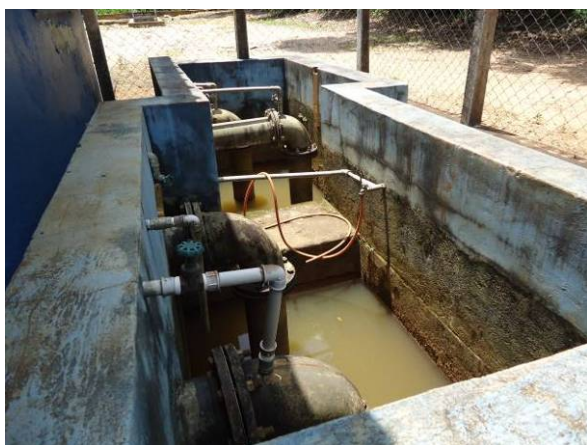
Figura 11. Vista do Poço de Sucção
